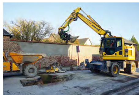
Rue L.-Bobet, les travaux de voirie se poursuivent : ici sur le réseau d'assainissement
